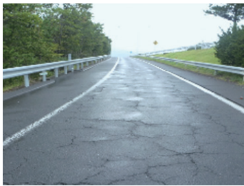
傷んだ路面のようす
